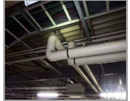
アスベスト含有が確認されている建物内配管エルボ部
