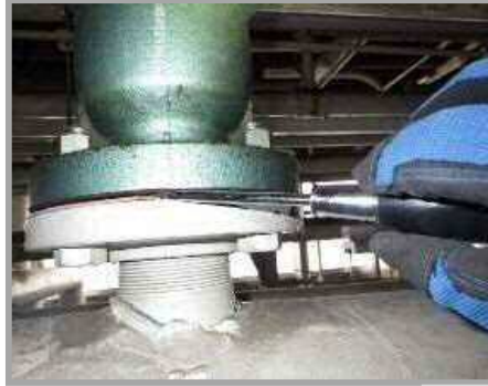
アスベスト含有が確認されている建物内配管断熱材接合部
