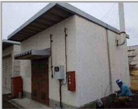
仕上げ塗材にアスベスト含有が確認されている危険物倉庫
