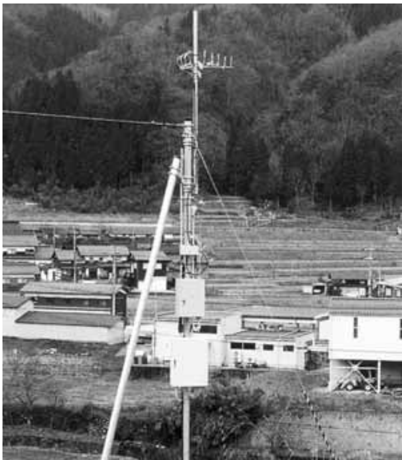
デジタル化に向けてのギャップフィラーの設置
