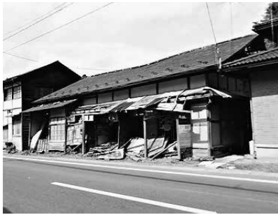
危険なまま放置された空き家
