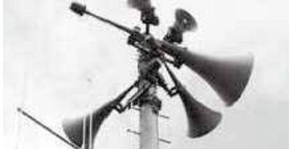
防災行政無線の屋外マスト
