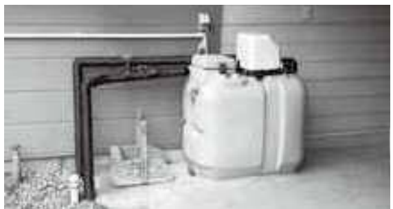
設置した受水槽
