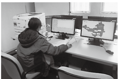
一関市水道施設管理システム（東部水道課）
