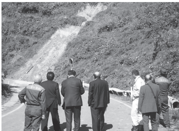
市道清水横沢川線ののり面崩落現場
