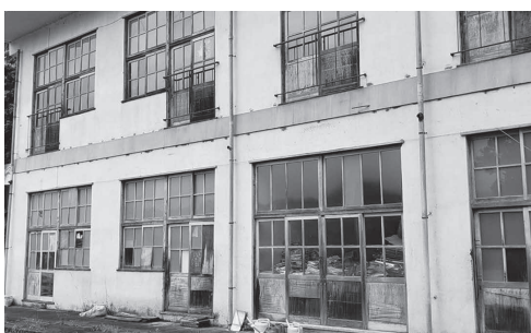
傷みが激しく倒壊などが懸念される興田中学校旧校舎
