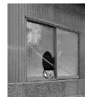
窓が割れた 管理不全空家
