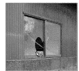
窓が割れた管理不全空家
