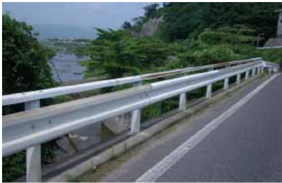
防護柵の腐食
