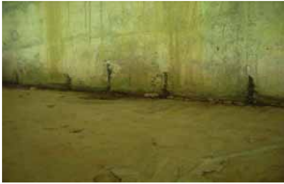
下部工の鉄筋露出
