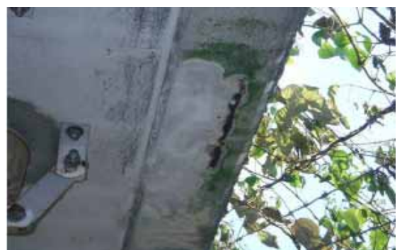
床版の鉄筋露出
