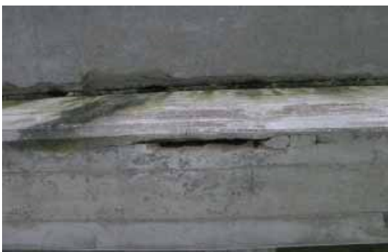
主桁の鉄筋露出
