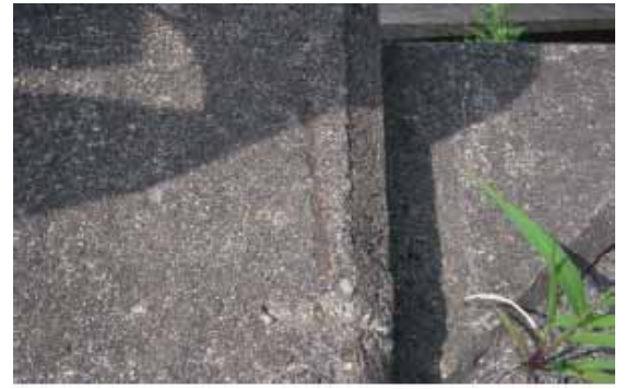
地覆部の鉄筋露出
