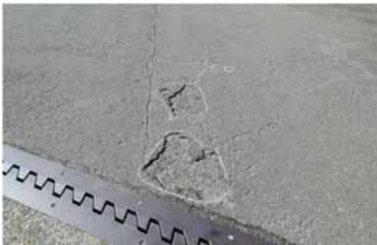
路面の亀裂、凸凹
