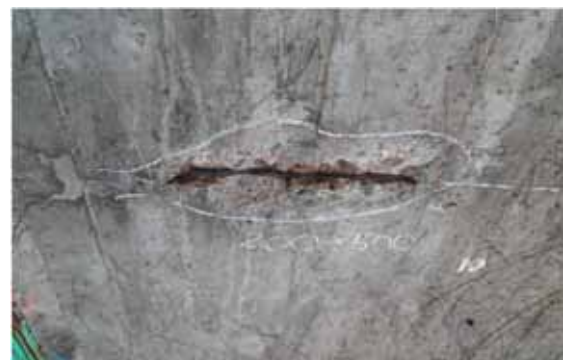
床版の鉄筋露出
