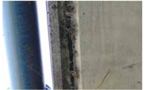
地覆部(下面)の鉄筋露出
