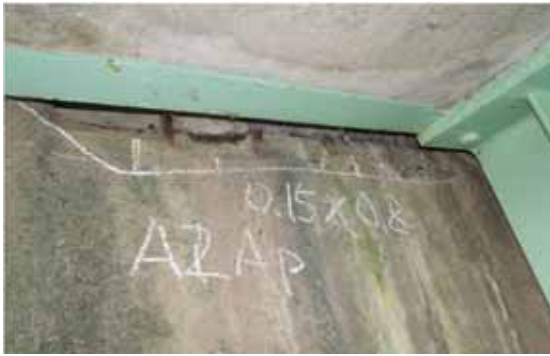
下部工の鉄筋露出
