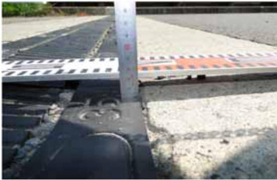
伸縮継手部の段差
