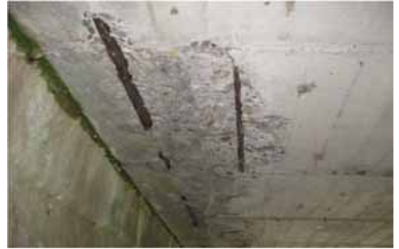
床版の鉄筋露出
