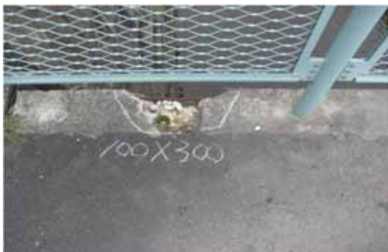
地覆部の破損、鉄筋露出
