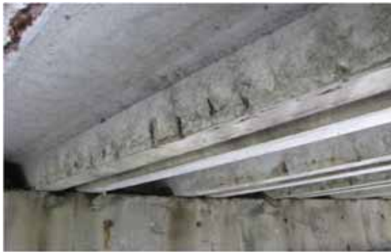
主桁の鉄筋露出
