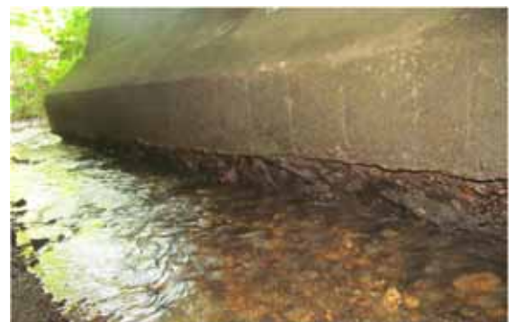
基礎の洗堀(河床低下)
