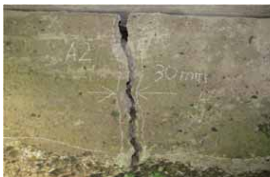
下部工(豎壁)のひびわれ
