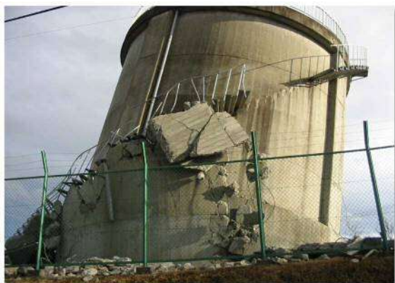
平成 23 年4月7日の余震で倒壊した沢配水池
