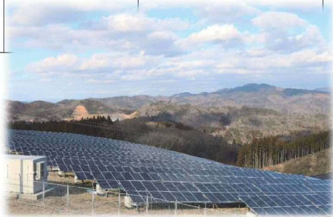
束稲山麓に整備された太陽光発電所
