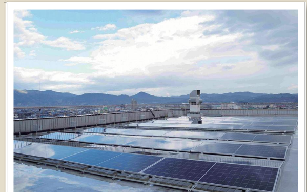
市役所本庁舎屋上に設置された太陽光パネル
