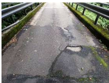
写真-3.5 路面の凹凸
