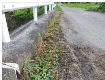
写真-3.6 土砂堆積
