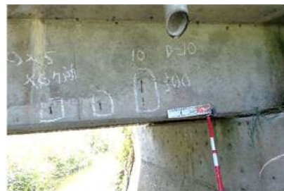
主桁の剥離・鉄筋露出
