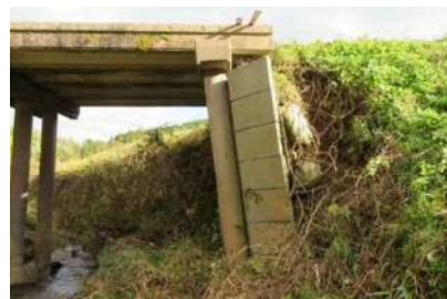
下部工の傾斜
