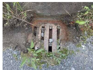
写真-3.7 排水施設の土砂詰まり
