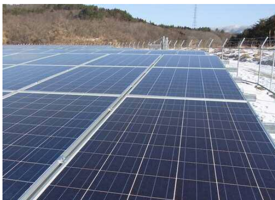
写真① 一関市東山太陽光発電所
