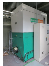
チップボイラー
