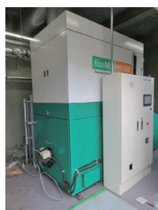
チップボイラー
