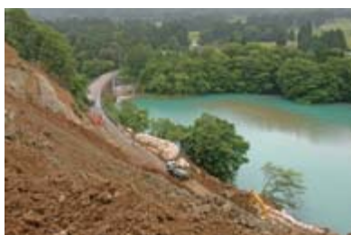
▲現在通行止めとなっている矢びつダム周辺の国道342号。日々大量の土砂が搬出されている(5月30日撮影)
