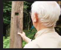
当時の蔵の屋根板。直径6号ほどの機銃掃射の跡が残っている
