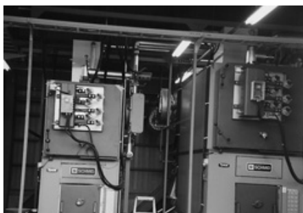
稼動しているチップボイラー（矢巾町）
