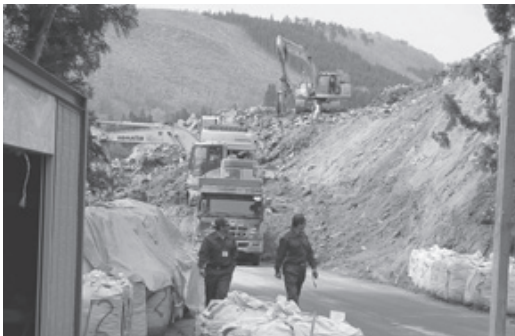
国道342号殿美町下真坂地内崩落箇所
