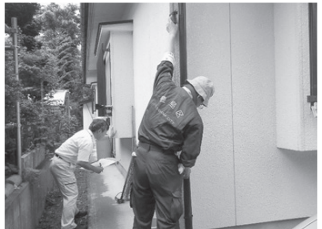
家屋被害調査
