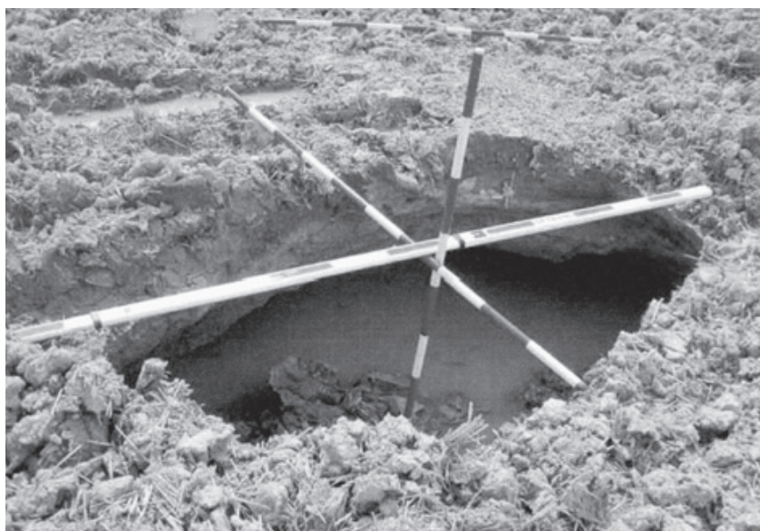
亜炭坑跡地（陥没した農地）
