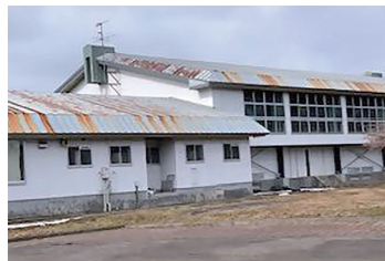
屋根の修繕が待たれる公共施設
