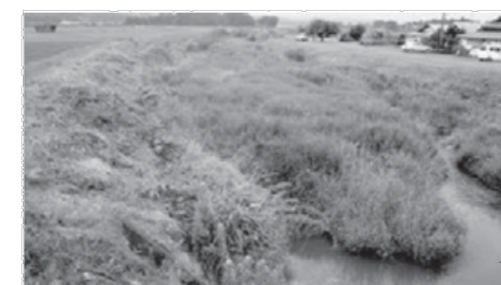
花泉小学校付近の金流川土砂堆積状況
