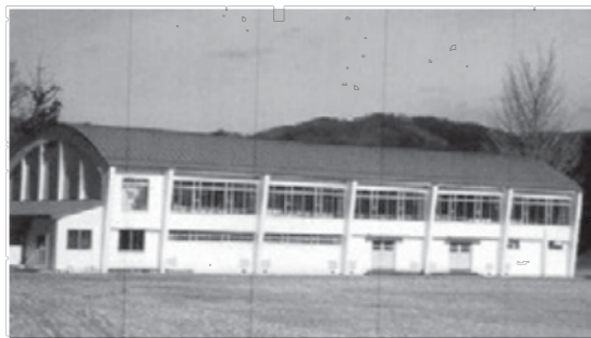
雨漏りする体育館
