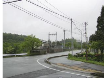
磐井川発電所
