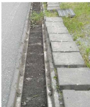
側溝に堆積した土砂
