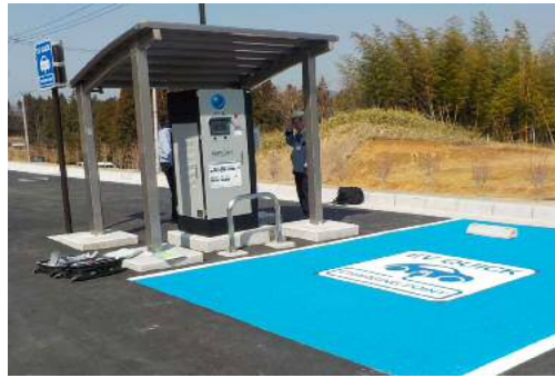
道の駅むろね駐車場内の急速充電設備
