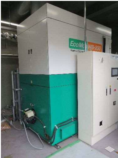
千厩小の木質チップボイラー
