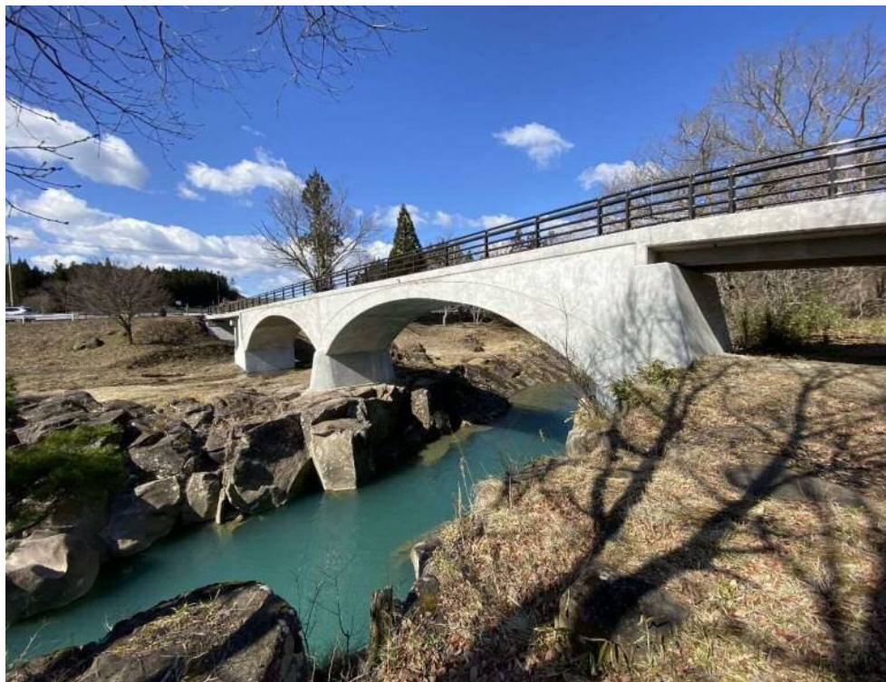
巖美溪に架かる「長者滝橋」は貴重な近代化遺産として国の登録有形文化財に登録 (令和元年に長寿命化を目的とした補修工事を実施)
