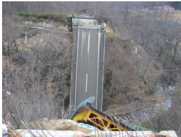
平成20年に発生した岩手・宮城内陸地震で落橋した祭時大橋
