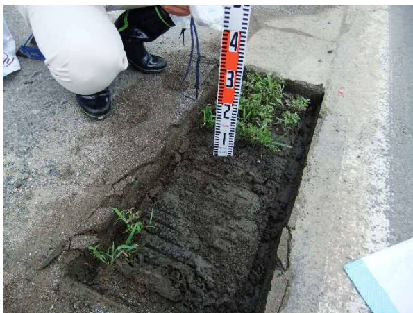
堆積した土砂
