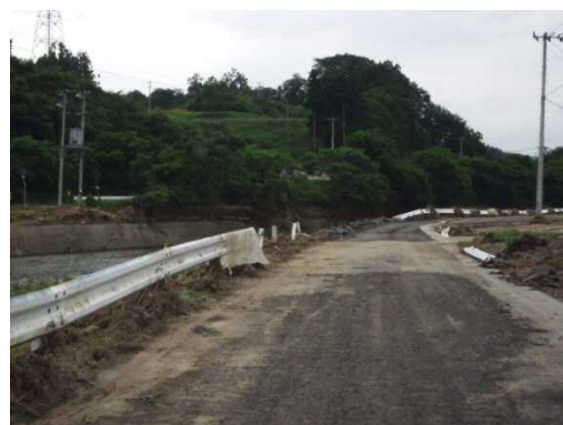
冠水によりガードレールが流された市道
