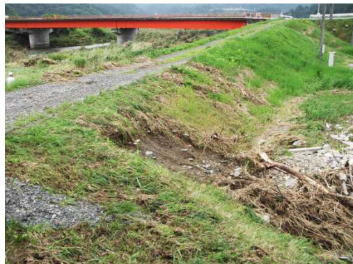
十二木橋下流堤防越水箇所
