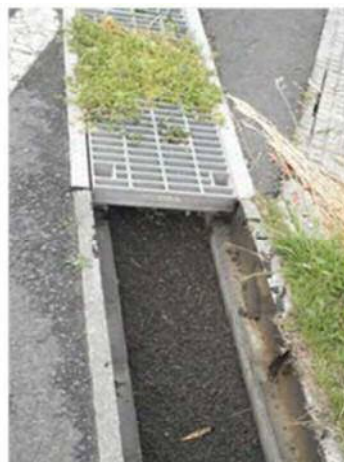
堆積した土砂
